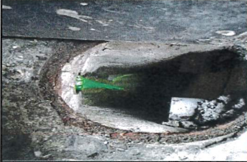
RC1 : Résurgence de colorant dans RC1 lors des essais sur les installations eaux usées de l'appartement
