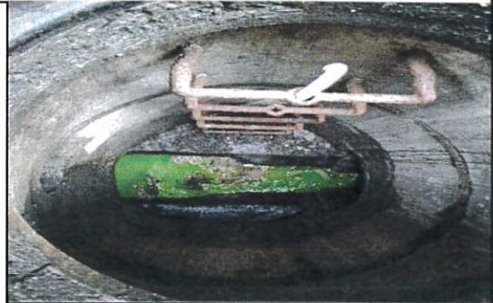
RUN1 : Résurgence de colorant dans RUN1 lors des essais sur les installations eaux usées de l'appartement
