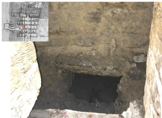
Figure 20 : Cavité repérée lors des investigations visuelles - Plancher bas galeries souterraines - PH SS-2
