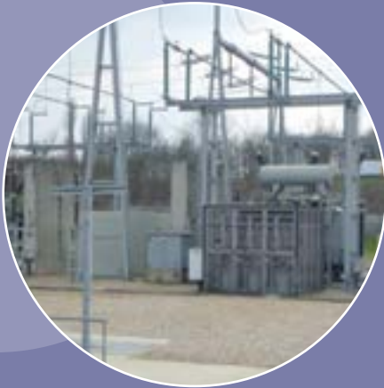
Poste Source de Saules alimentant une partie de la concession.
